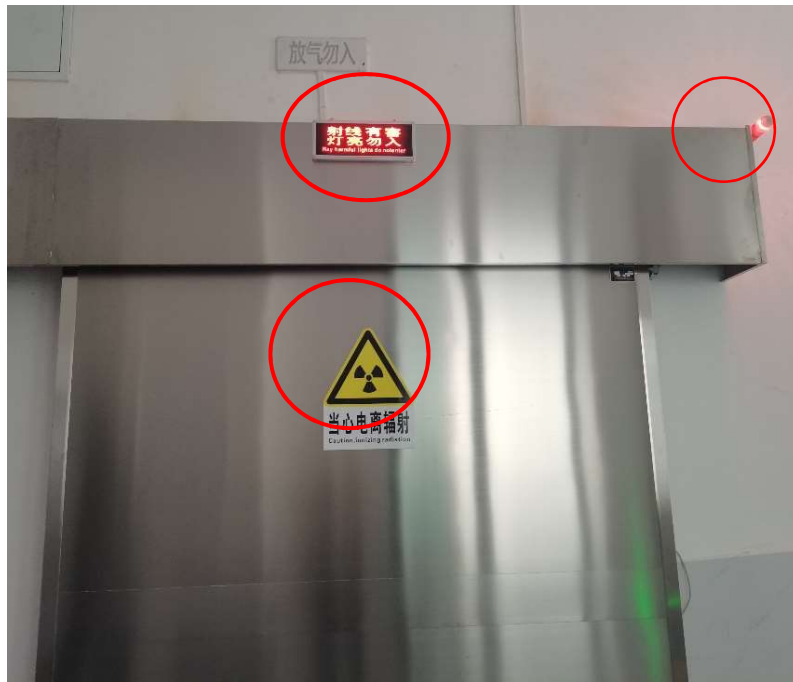
图 3-3 本项目当心电离辐射警示标志及工作状态指示灯
