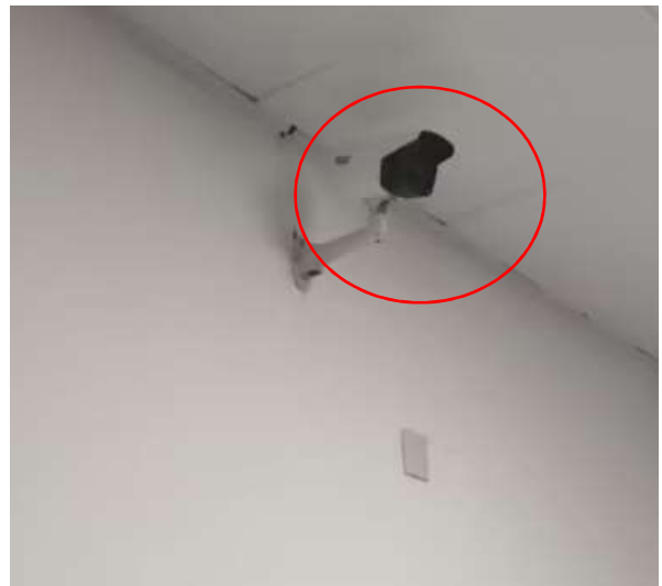
(b) 机房内摄像头（北墙）
