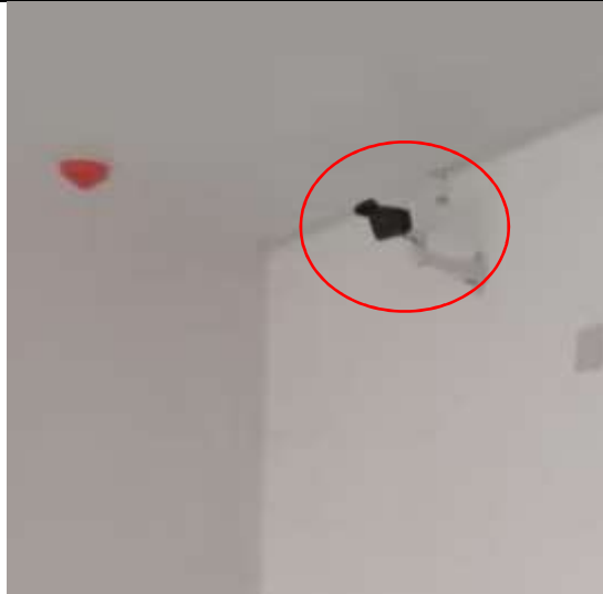
(a) 机房内摄像头（南墙）
